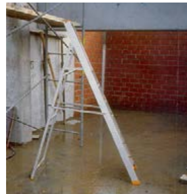
Figuur 12: Een ladder op een gladde betonvloer plaatsen kan zware ongevallen tot gevolg hebben
