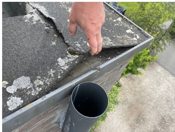
foto 8 - losse verbinding met dakrandprofiel hoek 1
