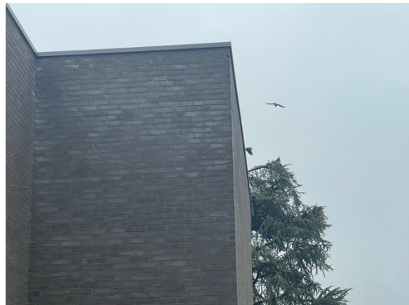
foto 4 - barsten in gevelmetselwerk
