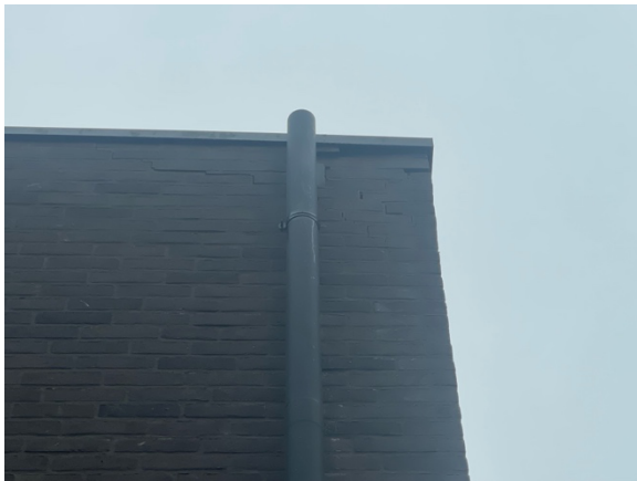
foto 3 - barsten in gevelmetselwerk
