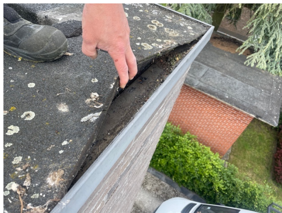
foto 10 - losse verbinding met dakrandprofiel hoek 2
