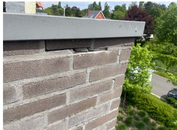
foto 22 - barstvorming thv de hoek
