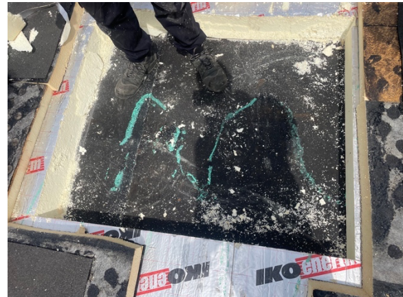
foto 48 - beperkte verlijming isolatie
