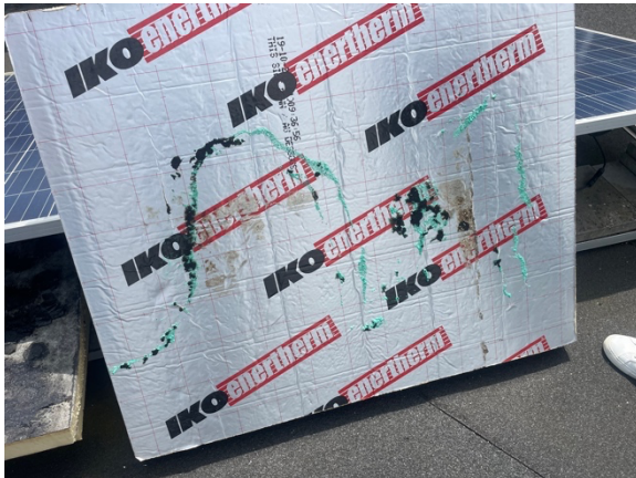
foto 47 - beperkte verlijming isolatie
