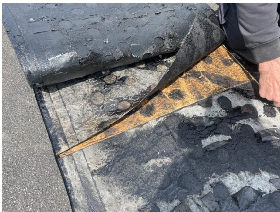
foto 31 - losse cachering bovenzijde plaat
