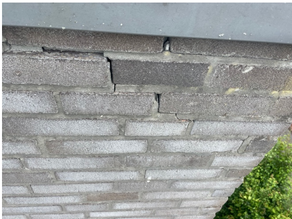
foto 21 - barstvorming thv de hoek
